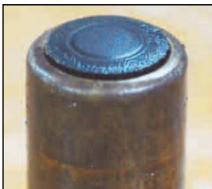
ドレンで弁ゴムが僅かに膨潤 (経過年数9年)
