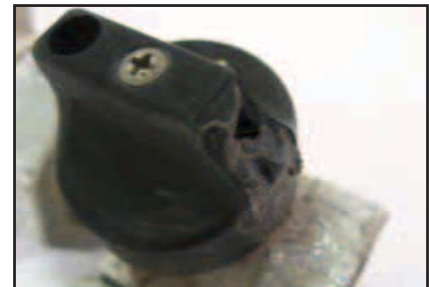
つまみの破損 海岸から1km（経過年数9年）
