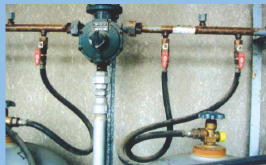
高圧集合管と圧力調整器の高圧ユニオン等がいちじるしく腐しょくしています。
