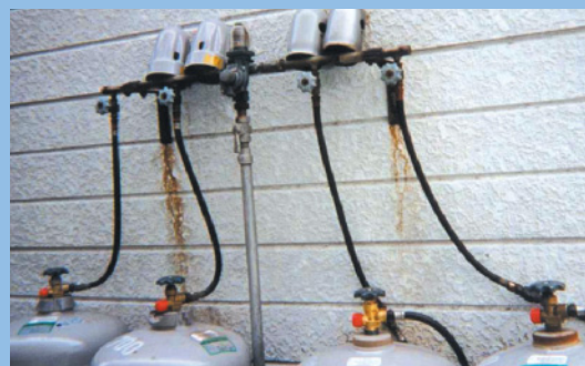
高圧ホースが長く、たるんでいると、再液化現象により容器交換時にガス放出量が多くなります。
