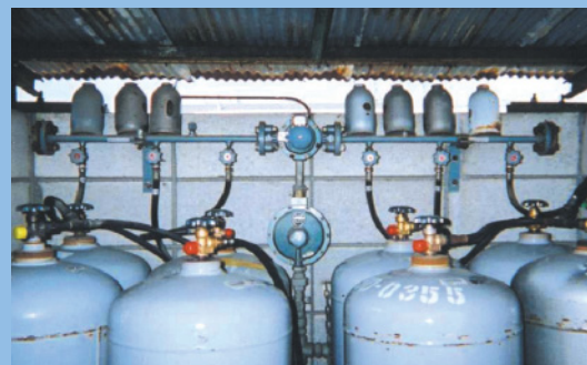
6本立集合装置に8本の容器が設置されています。タコ足による増設は、液移動によるトラブルが発生するおそれがあります。
