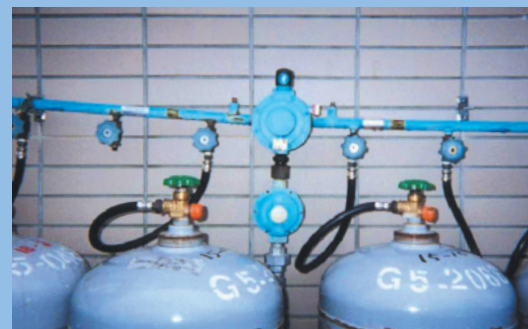
集合装置の左側が高く、圧力調整器の接続部に応力がかかりガス漏れが発生するおそれがあります。
