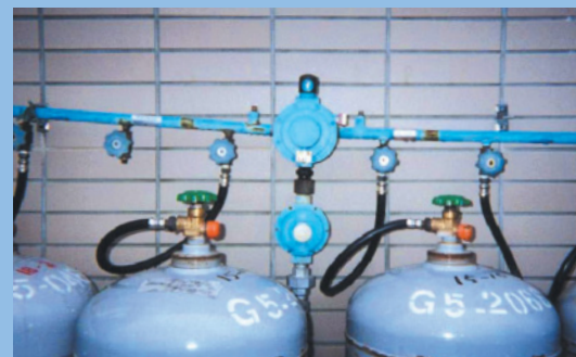
集合装置の左側が高く、圧力調整器の接続部に応力がかかりガス漏れが発生するおそれがあります。
