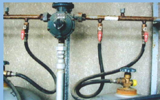
高圧集合管と圧力調整器の高圧ユニオン等がいちじるしく腐しょくしています。
