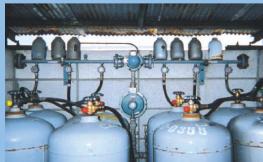
6本立集合装置に8本の容器が設置されています。タコ足による増設は、液移動によるトラブルが発生するおそれがあります。
